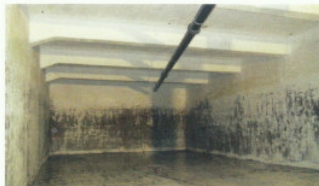
Korrosionsschäden im Innern des Behälters waren durch Aufweichungen in der Beschichtung gut zu erkennen.
