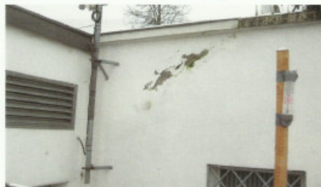
Der Trinkwasserbehälter auf dem Hoyerberg in Lindau war nach jahrelangem Betrieb sanierungsbedürftig.
